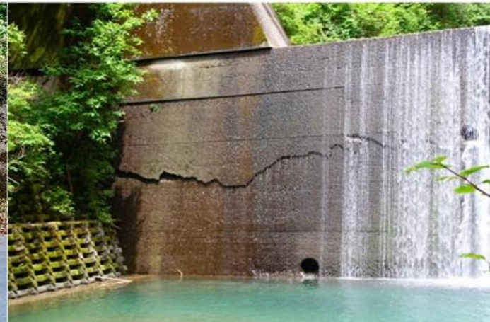
被災状況：谷止工のクラック
